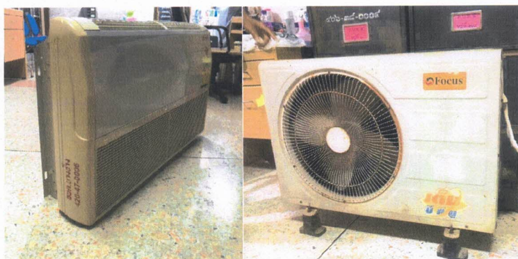
เครื่องปรับอากาศ(ขนาด16,000 BTU)ชนิดตั้งพื้น หมายเลขครุภัณฑ์ 420-47-0006
